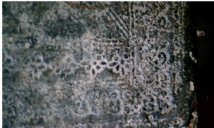
Foto 2. Detaliu de degradare biologică (atac fungic)
